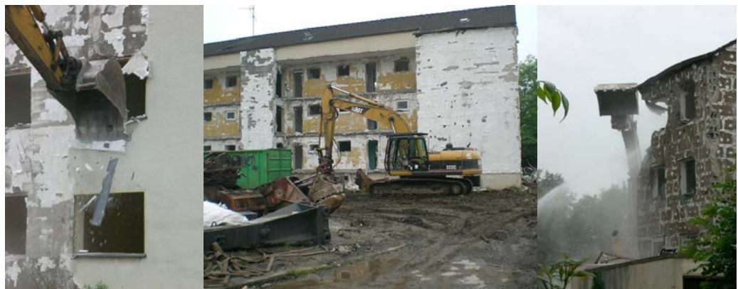
Bild 27: Mechanische Abschälen von WDVS mit EPS beim Rückbau eines Übergangswohnheims in Dortmund im Jahr 2009 (©Carsten Hördemann).
