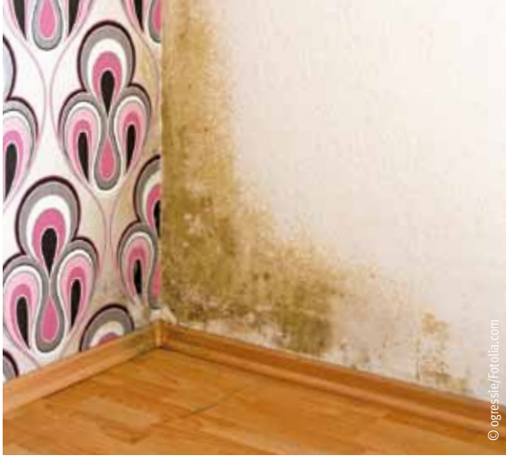
Schimmelbefall im Wohnbereich
