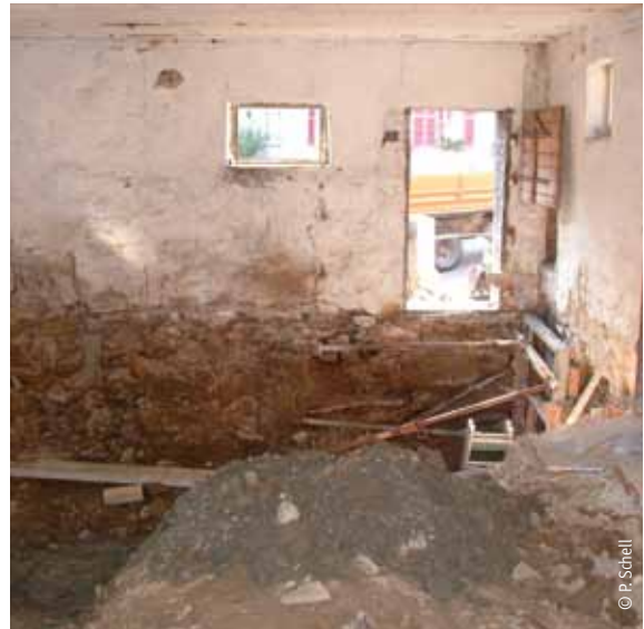
In manch altem Gebäude noch anzutreffen: Fußboden direkt auf Erdreich verlegt. Dann muss der Boden ausgehoben werden – sofern die Statik es erlaubt, bis zur Unterkante des Fundaments.
