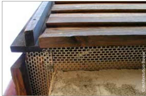
Belüftungsbleche im Sockelbereich: Stülpchalung in handwerklich sauberer Eckausbildung. So haben die Stirnseiten der Bretter Luft zum Trocknen.
