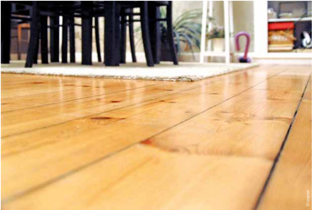
Gut erhaltener und gepflegter Holzdielenboden: Fugenbildung und Ergänzungen gehören zu einem in Würde gealterten Dielenboden.
