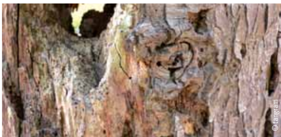
Holzschäden durch Schädlinge
